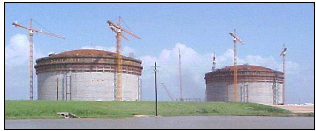
Freeport LNG regas plant, September 2006
